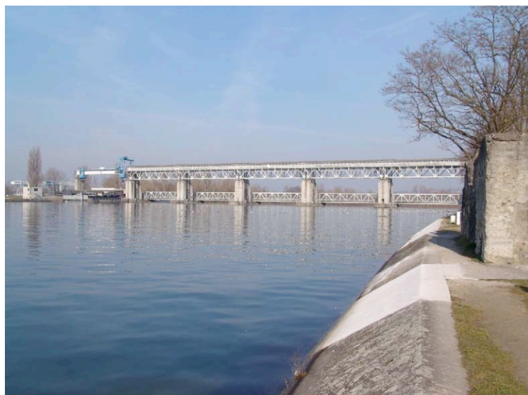
Abb. 8: Wehr in Märkt mit rechtsrheinischem Ufer aus Beton
